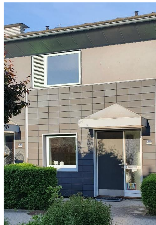
Køkkenvindue og vinduer på 1. sal skiftes til nye hvide vinduer, som vist
